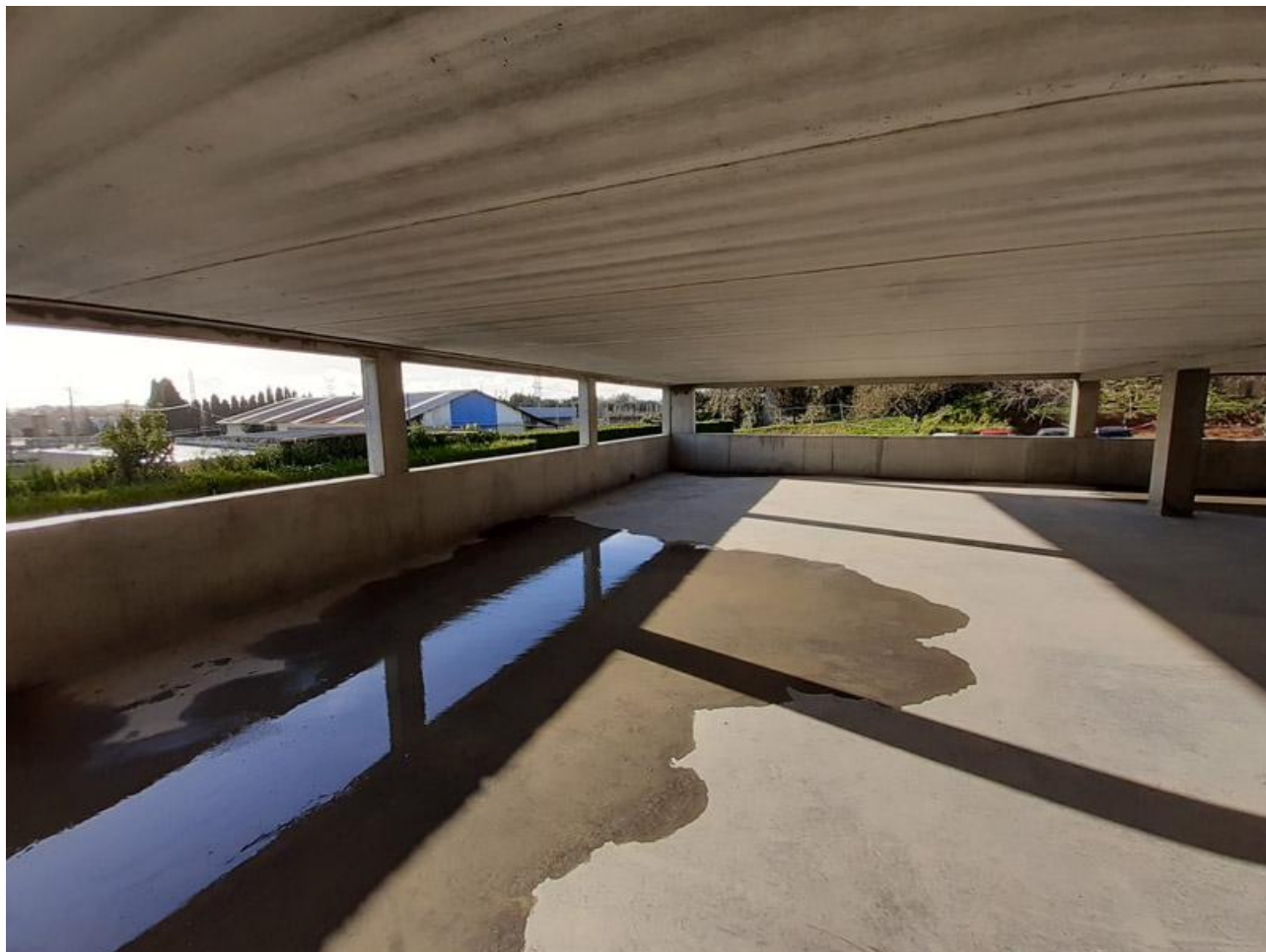
Extension sud, vue de la future salle de tri du premier étage
